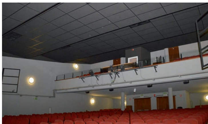
La sala ha estado cerrada hasta que se ha completado la instalación del nuevo techo
